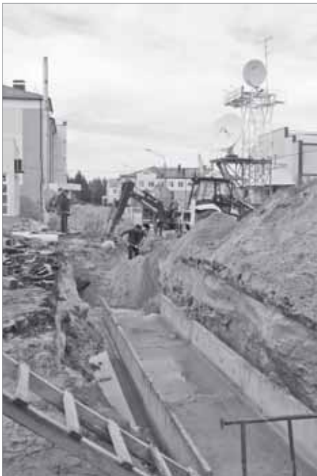
Под дорожным полотном коммуникации защищены железобетонными лотками
